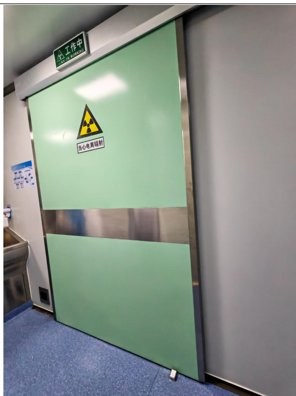
西侧医护人员进出防护门电离辐射警告标志
