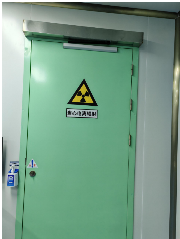
医护人员进出防护门自动闭门装置
